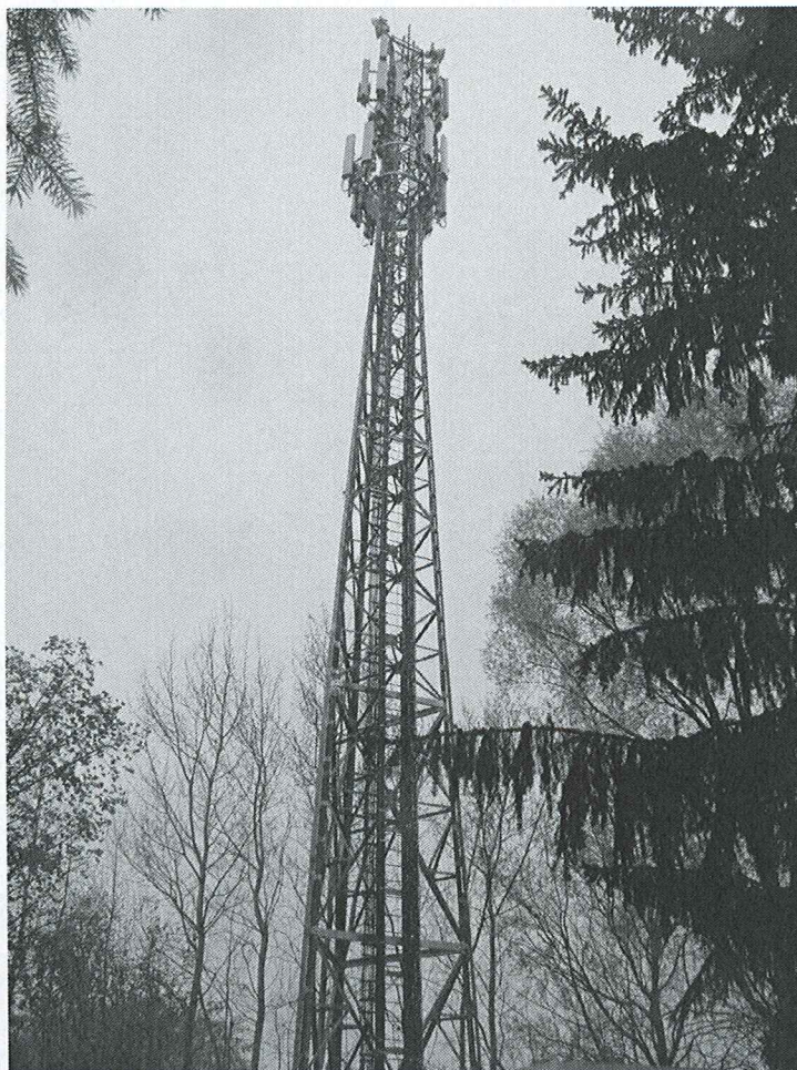
Zal. nr 1: Widok ogólny instalacji radiokomunikacyjnej.
